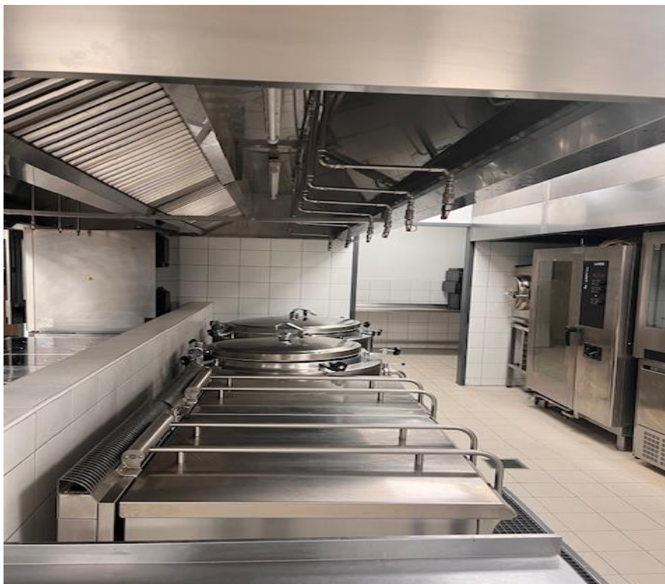
5. számú ábra, Elszívó ernyőbe telepített tűzoltó berendezés [28]
