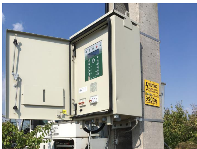
2. Ábra AS Tavrída Electric Recloser Vezérlőszekrény
