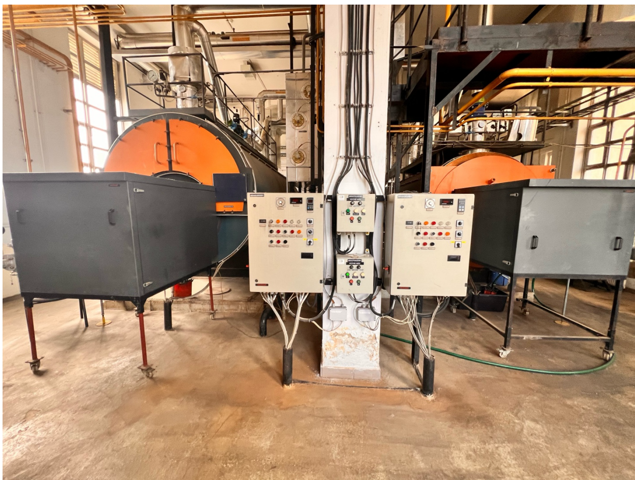
10.1. ábra A meglévő rendszer kazánjai a valóságban
