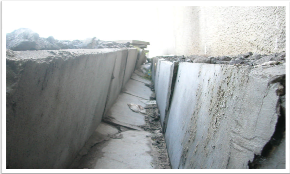
3. Számú kép: Felszínemelkedésre utaló károk a támfal lábánál
