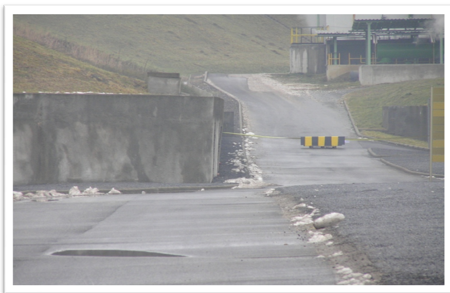
4. Számú kép: A támfal deformálódva
