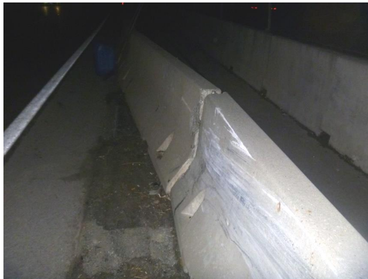
44. ábra Javítható sérülés a betonelemen (forrás: Magyar Közút)
