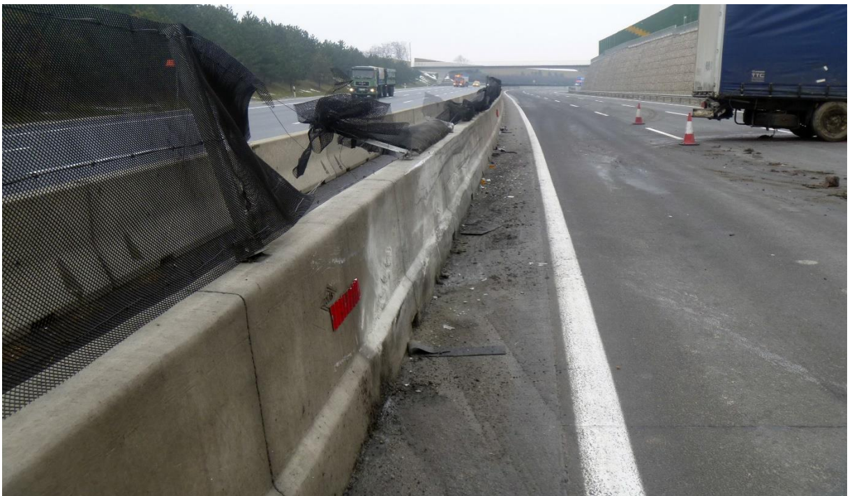
48. ábra Monolit betonfal, tehergépjármű baleset után az M0-áson 2013-ban (forrás: Magyar Közút)
