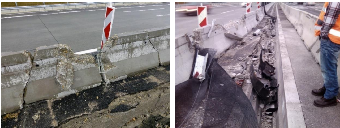
49. ábra Ferrobeton KT1 elemek tehergépjármű baleset után az M0-áson 2013-ban (forrás: Magyar Közút)
