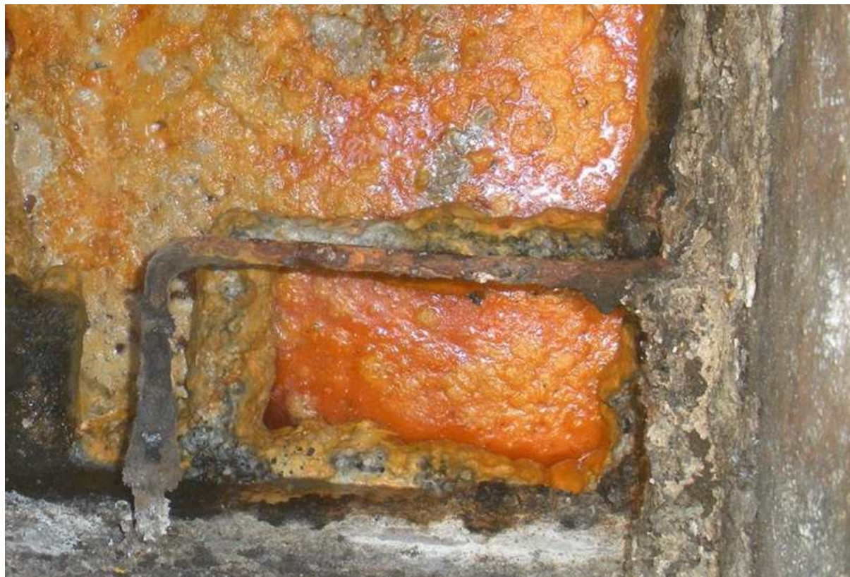
3.2. ábra: rozsd megjelenése egy zsírfogóban
