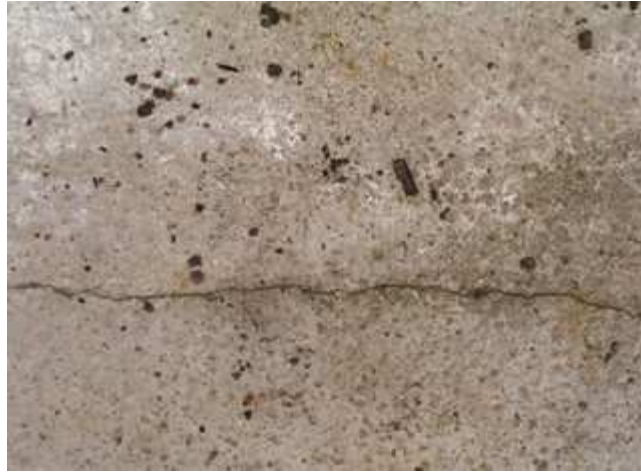
2.1. ábra: karbonátosodott betonfelület
