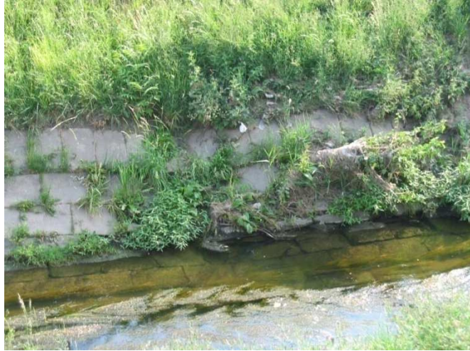
9.3. ábra: növényzet károsító hatása: megsüllyedt betonburkolat fedlapok
