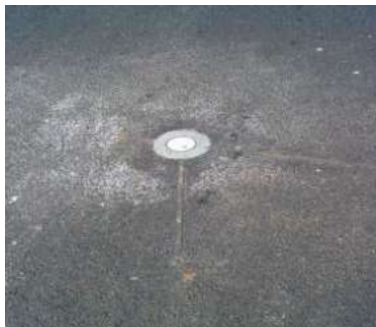
11. kép: ÚTMET állomás beépített érzékelő szondája a burkolatban
