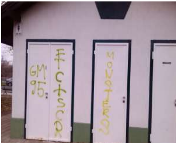
52. kép: Megrongált pihenői WC blokk
