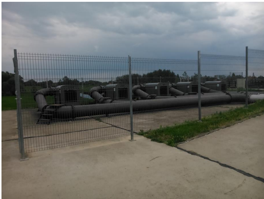
5.ábra Műtárgy melletti szivattyúk
