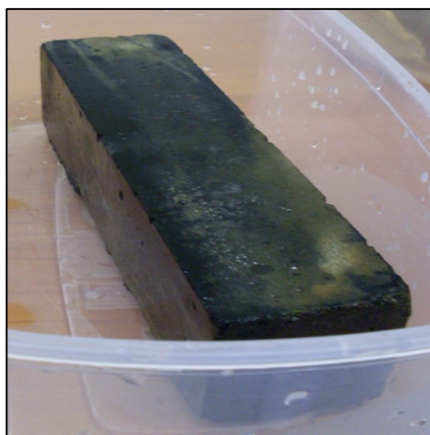
36. kép A homokfogó műtárgyban 3 hónapig tárolt betonhasáb felülete
