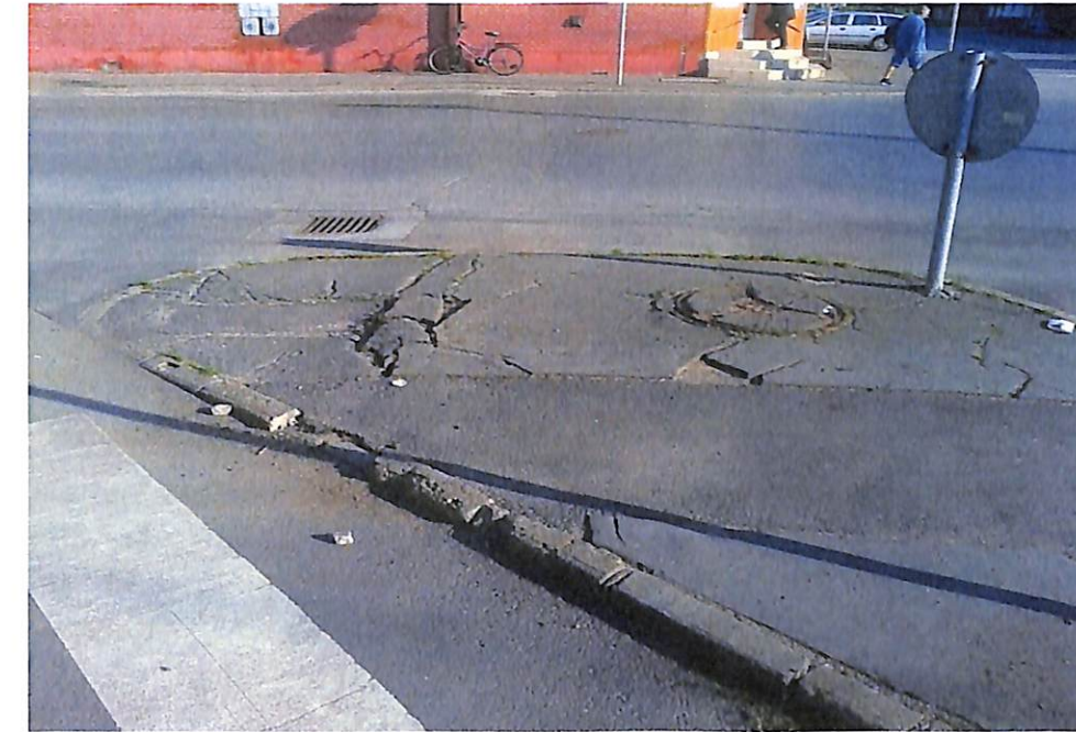
(4. kép: 33111. jelű bekötőúton található elválasztó sziget állapota)
