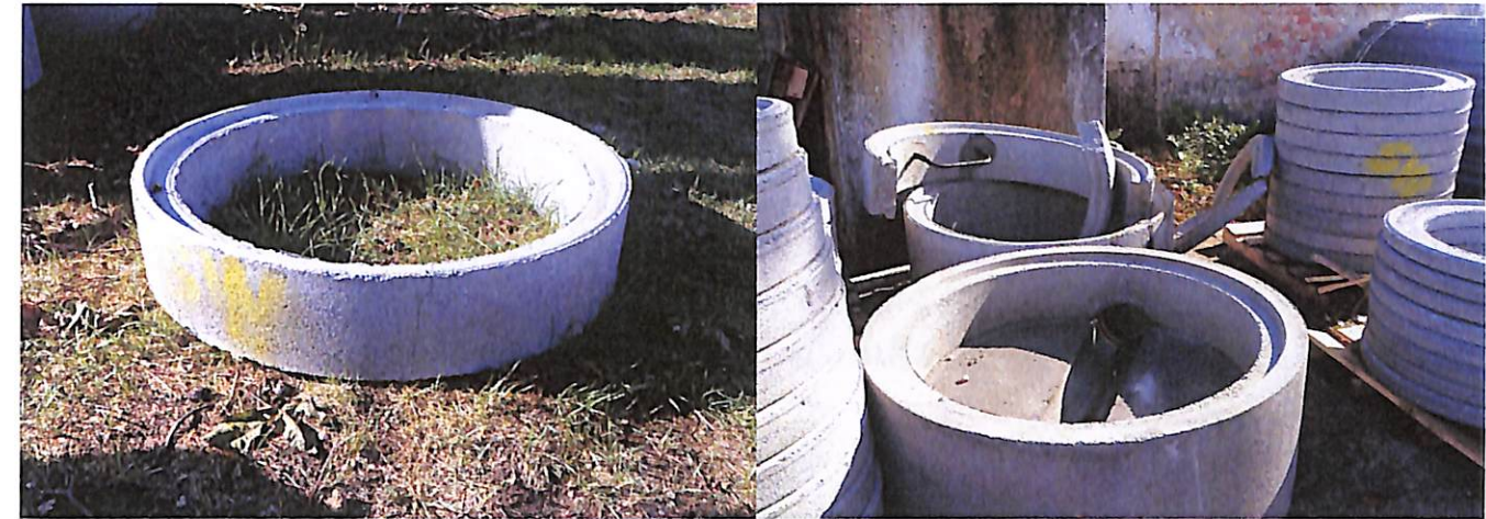
12. ábra Hajszálrepedés az aknamagasító gyűrűn 13. ábra Összetört betonelemek
