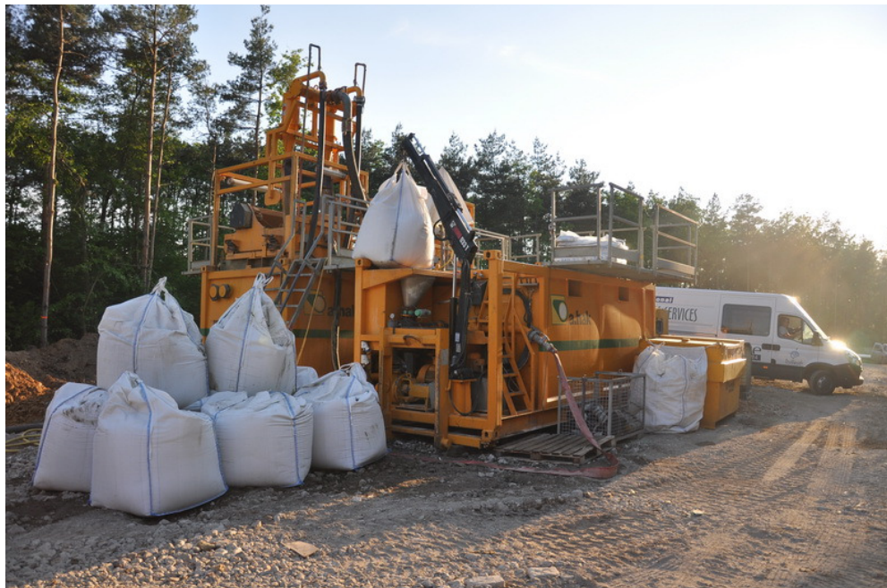
59.kép Kiszolgáló gépek telepítése Forrás: Dénes Pál, 2014
