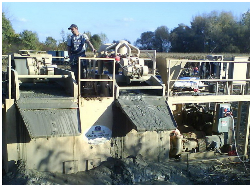
19.kép Nagy teljesítményű zagy szeparátor
