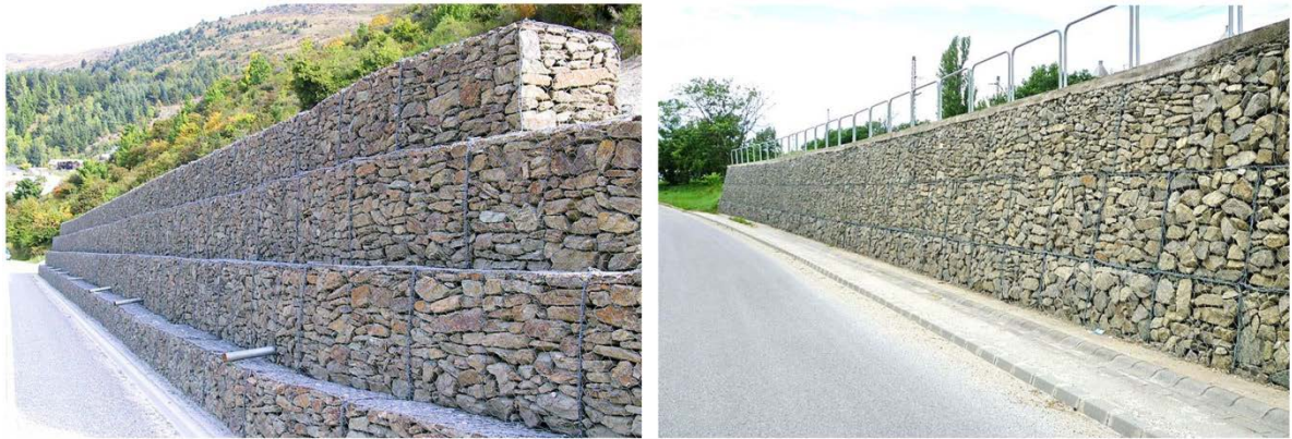
31. ábra: Gabion fal
