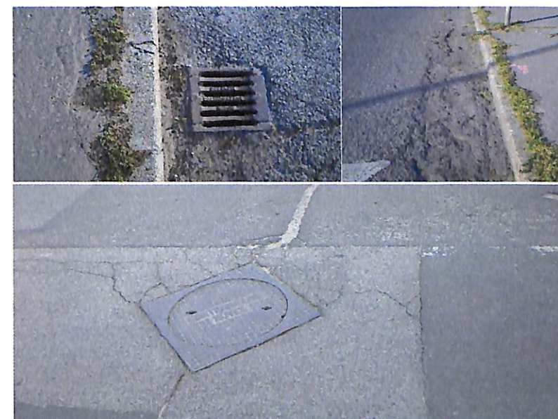
3. kép. Útburkolati hibák
