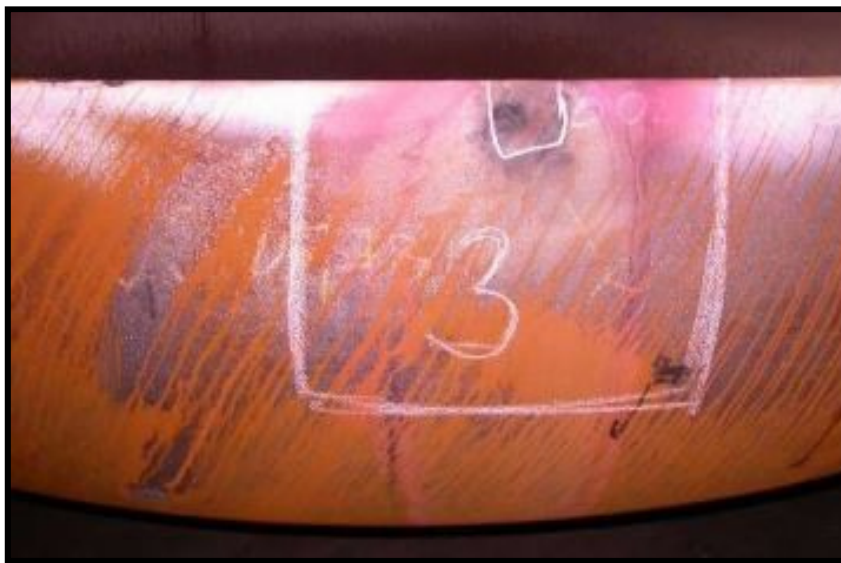
16. ábra Repedés jelölése az edényfenéken (a cég tulajdona)
