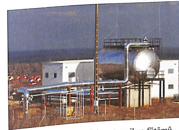
18. ábra Miskolci geotermikus fűtőmű forrás: PannErgy Zrt.
