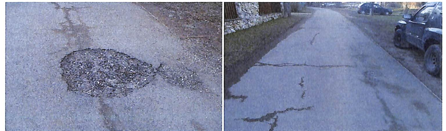
28-29. kép: Bükkös parti nyomvonal burkolati hibái
