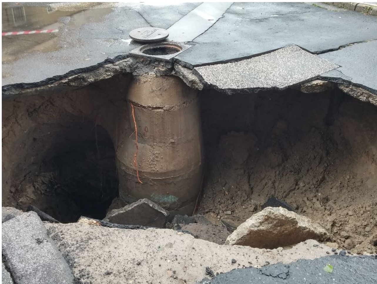
41. kép: A nem megfelelő alapozás következménye
