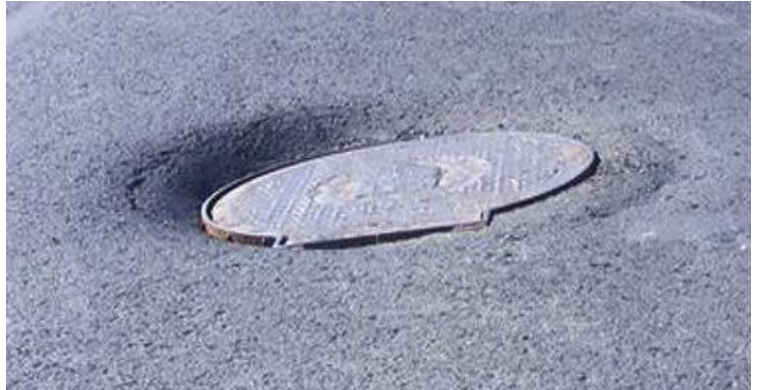
1. kép: megsüllyedt fedlap
