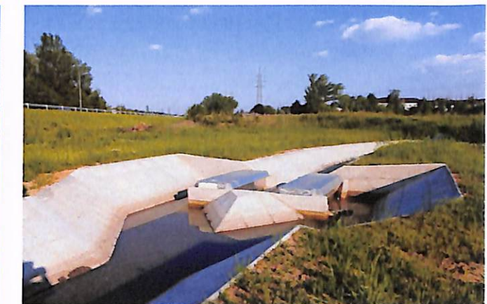
Csapadékelvezető árok hordalékfogó műtárggyal
