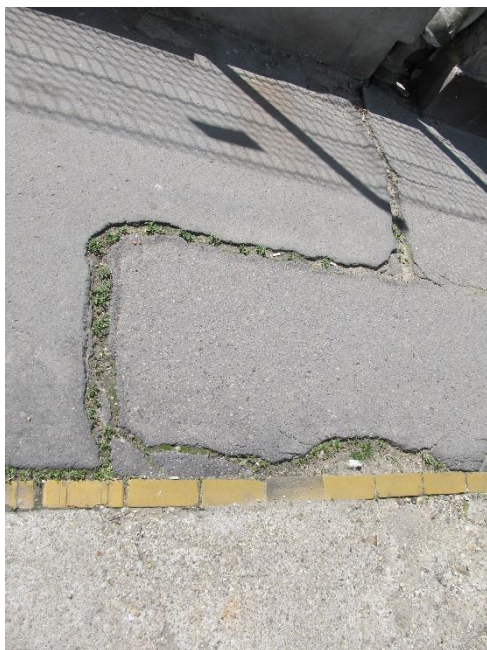
12. kép Járda burkolati hiba
