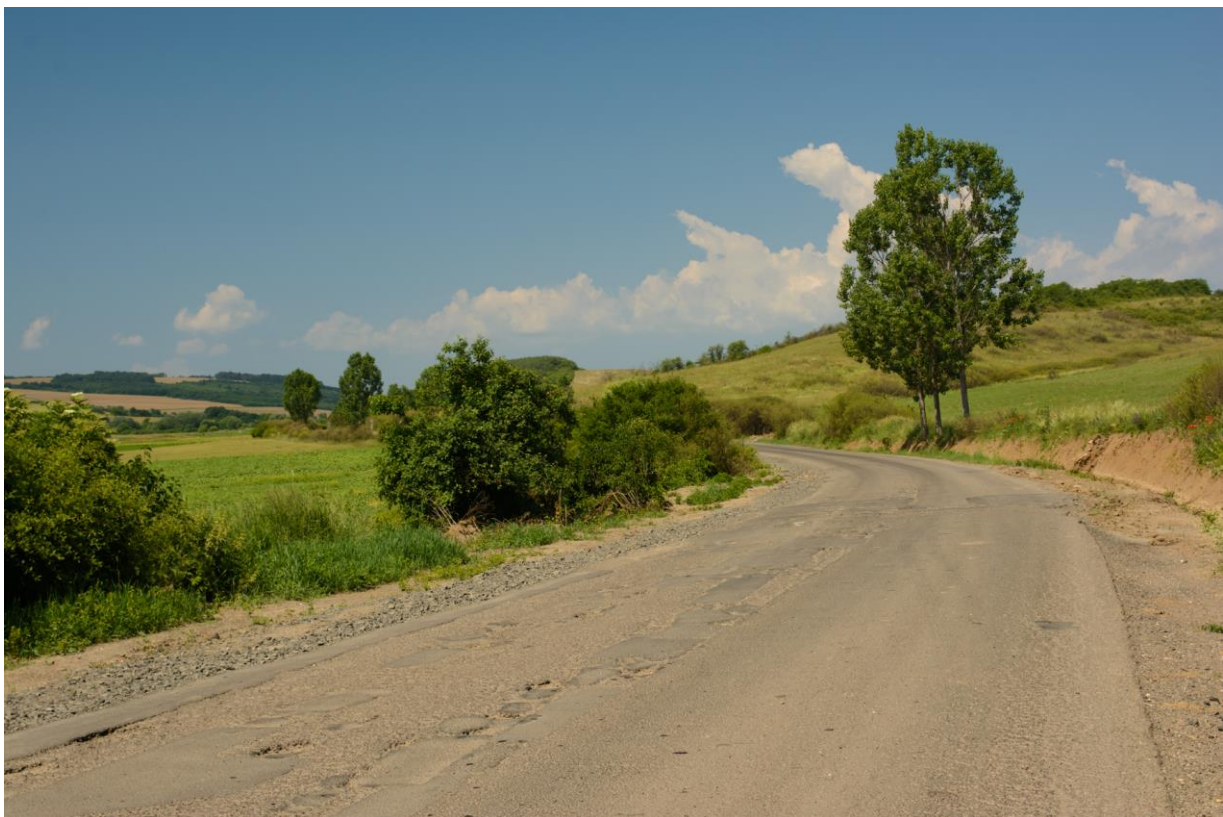
3. kép – 2116. j. összekötőút állapota a rekonstrukciót megelőzően
