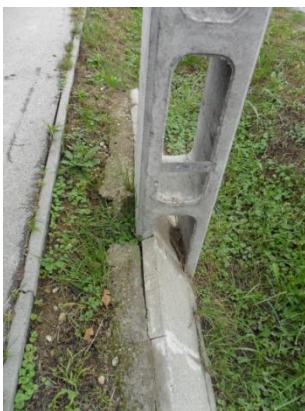
60. ábra Betonoszlop helytelen kivitelezése
