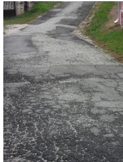
25. ábra Mellékutca / Repedés, bomlás
