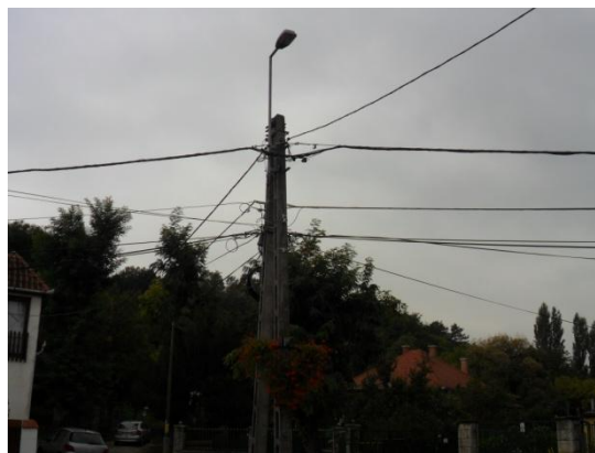
61. ábra Elektromos és telefonvezetékek
