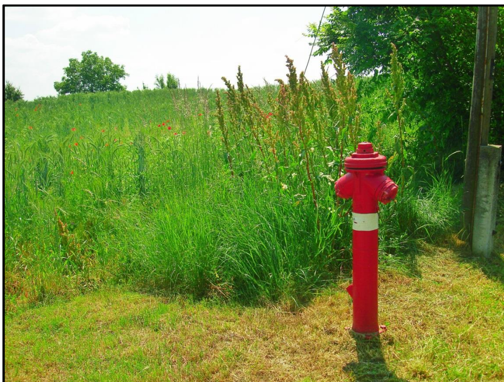
3. kép: Dorogi utca végén lévő földfeletti tűzcsap
