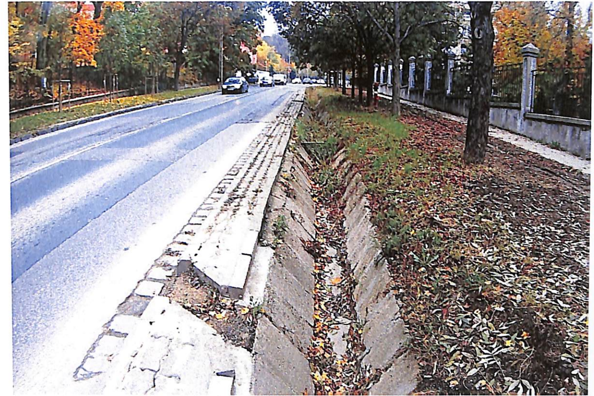
33.számú kép - Hordalékkal , falevéllal telített árok -
