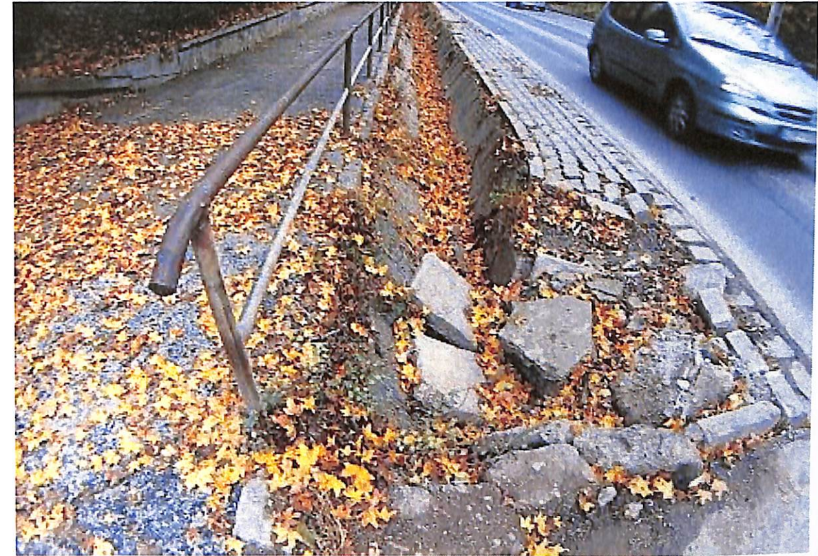
35.számú kép - Bedőlt, leszakadt árokburkoló elemek -
