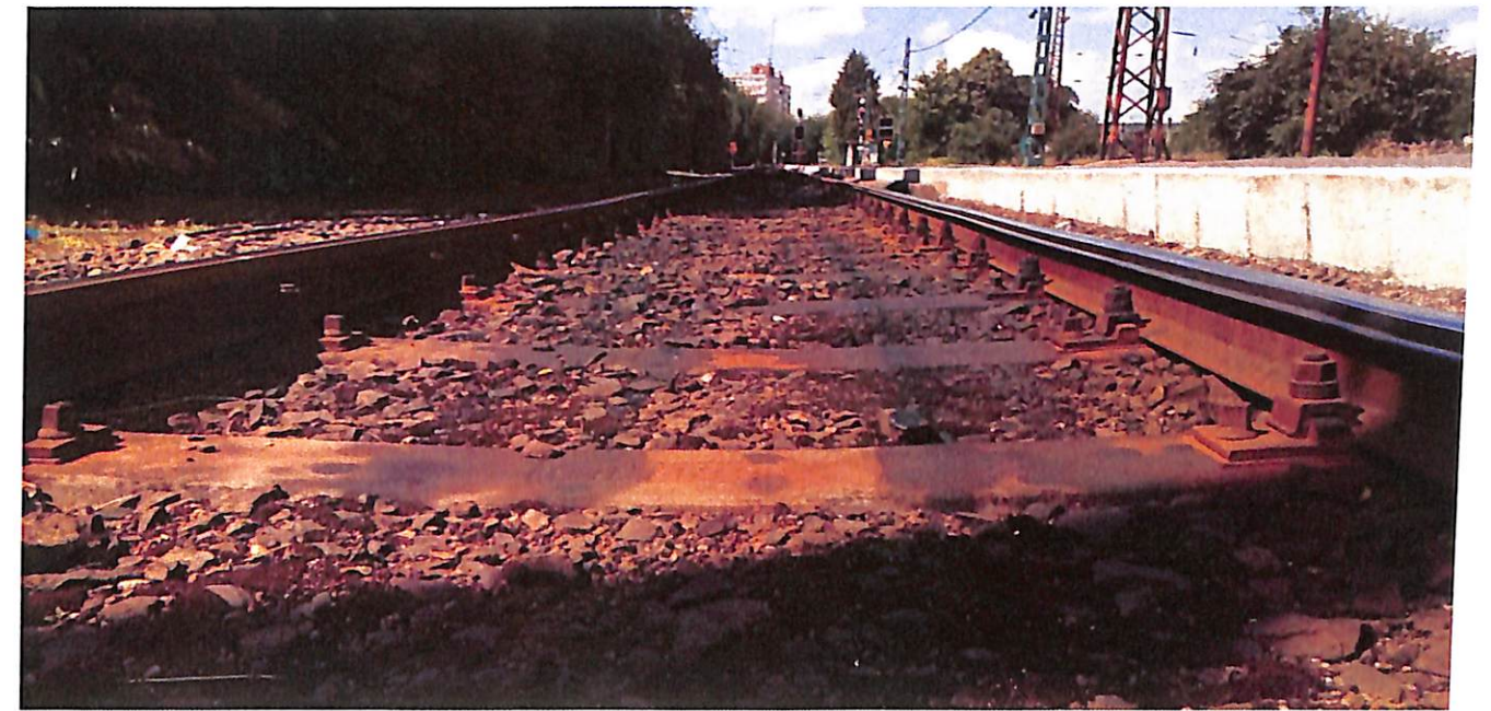
6. kép: Jobb vágány végpont felől nézve. Irány és fekszint hibák, elsározódott ágyazat.
