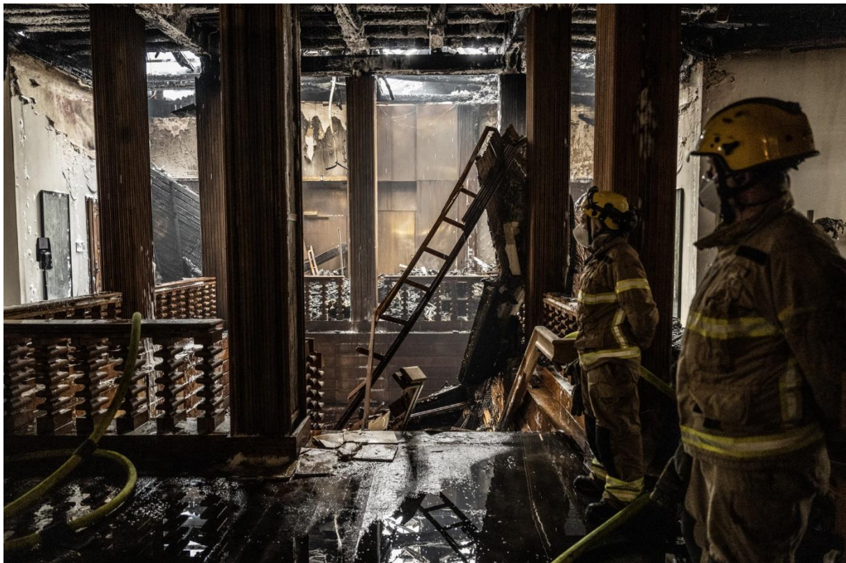
7. kép A tűzsdepalota kiégett belső tere a tűz eloltása után
