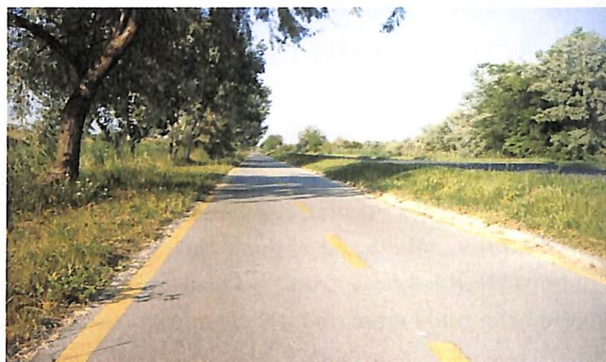
35. kép: A vízelvezetés hiánya a kerékpárút egy szakaszán
