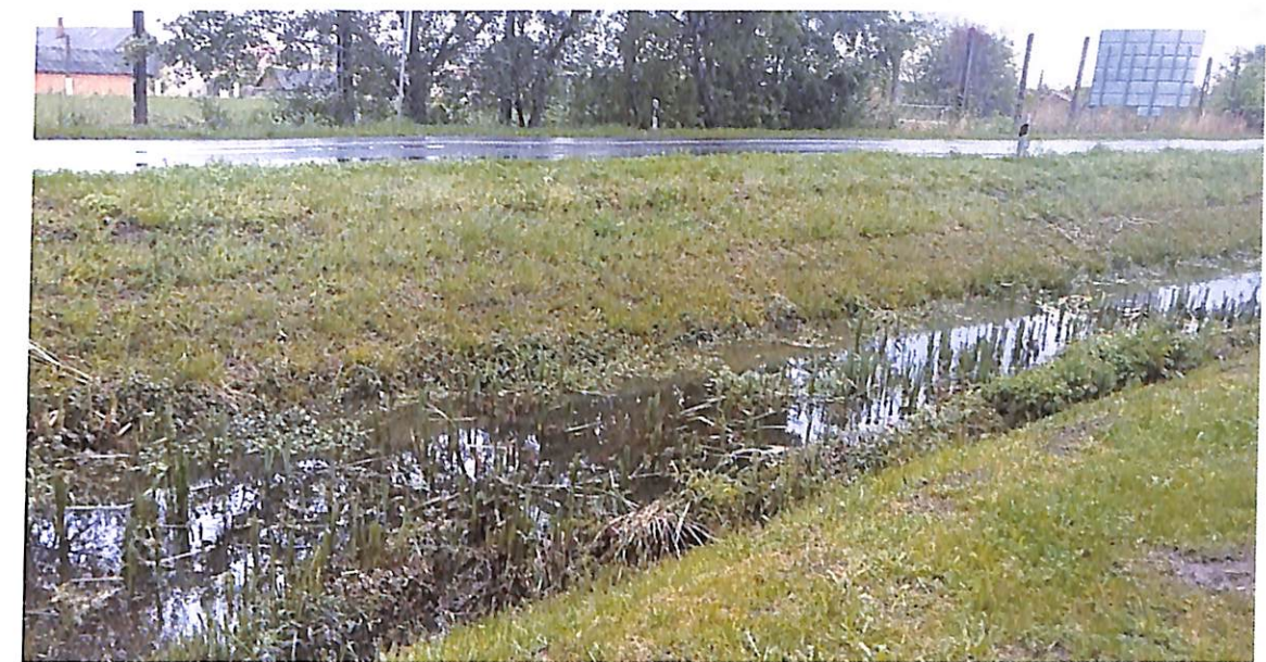
5. ábra – 6. sz főút melletti árokban pangó víz
