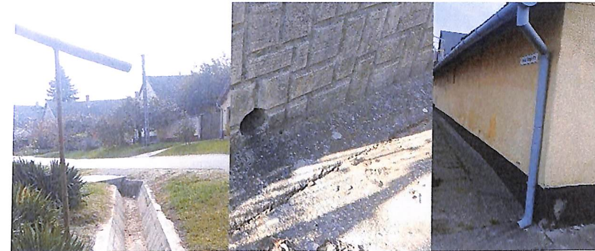
8. ábra – HÉSZ-nek nem megfelelő ereszcatorna kivezetések
