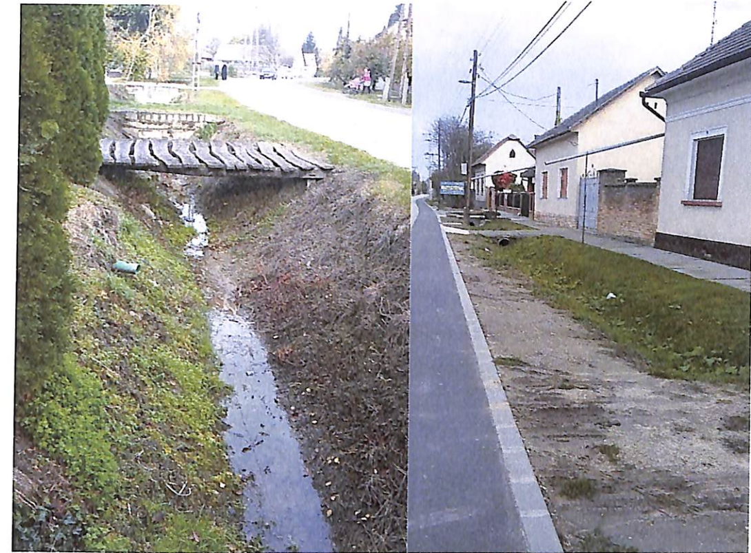
20. ábra – Fehérvári utca páratlan oldalán lévő nyílt árok 21. ábra – Fehérvári utca páros oldalán lévő nyílt árok
