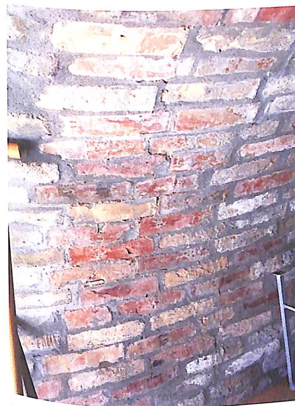
1. ábra 34. számú ingatlan pince repedése
