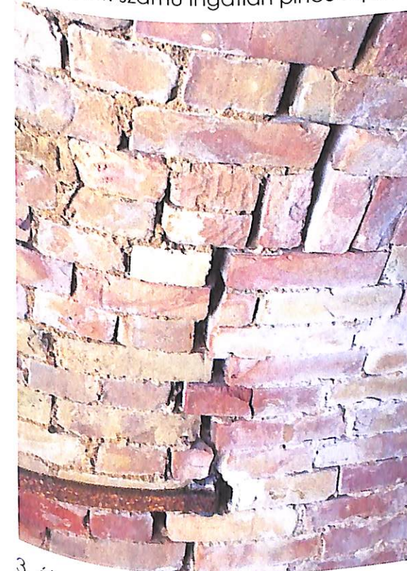
3. ábra 35. számú ingatlan pince repedése
