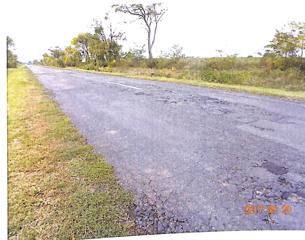
8. kép: 4644.jelű út 4+000 kmsz meglévő állapota
