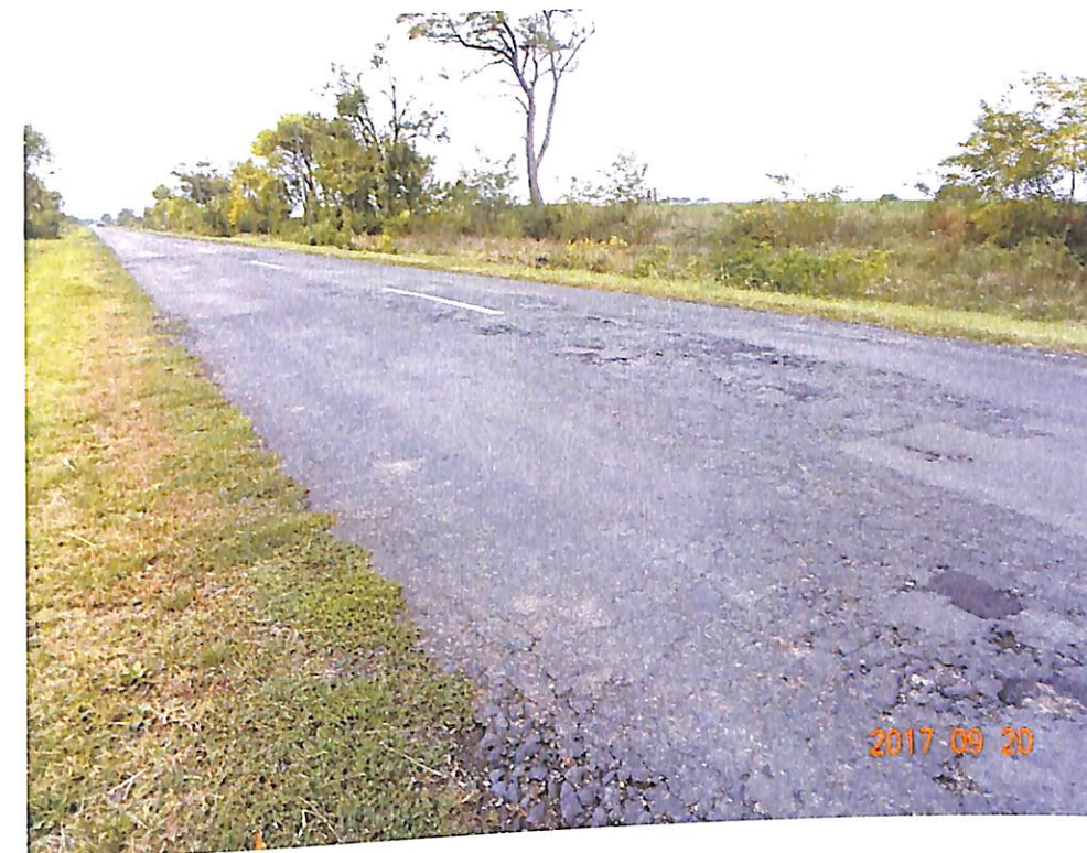
8. kép: 4644.jelű út 4+000 kmsz meglévő állapota
