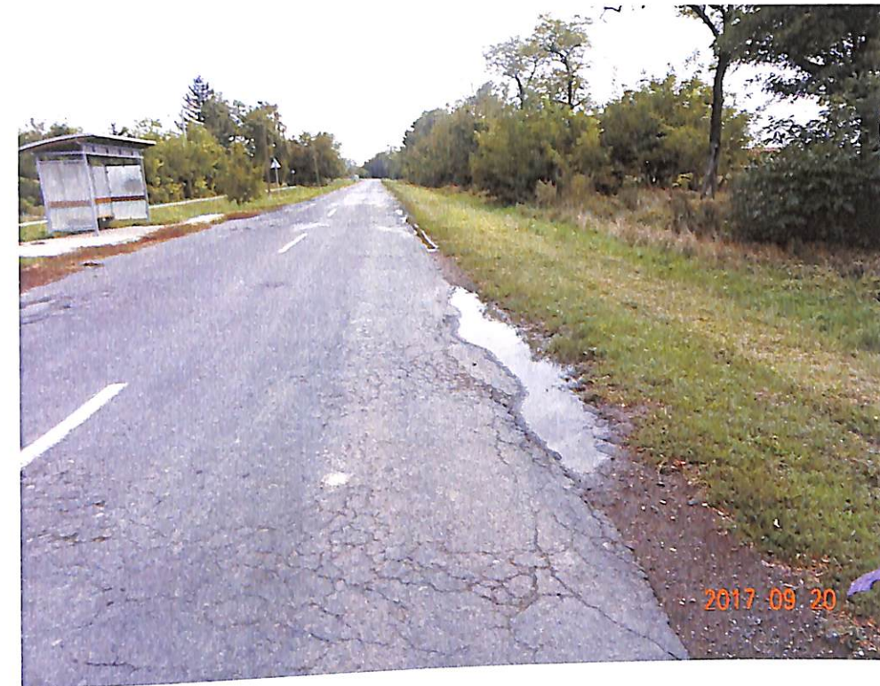
7. kép: 4644.jelű út 2+300 kmsz meglévő állapota
