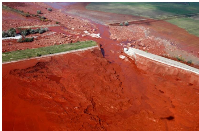
3. ábra: Kolontári vörösiszaptároló gátszakadás [Közigazgatási és Igazságügyi Minisztérium, 2010]
