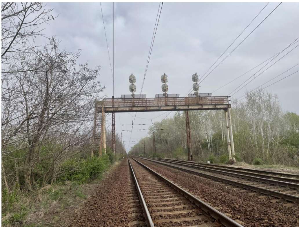
5. kép: Meglévő jelzőhíd
