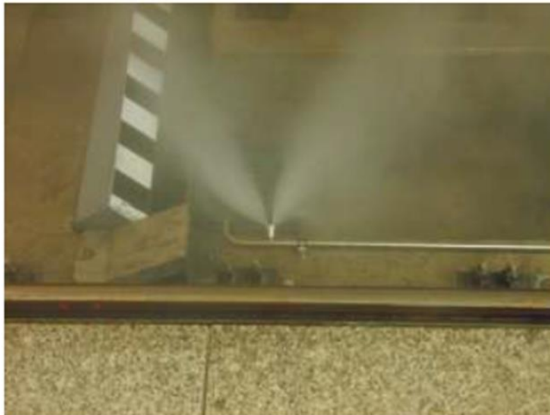
10. kép A peron melletti vágányoknál a szerelvény padlólemeze alatti tér oltására magasnyomású fix vízköd rendszer került telepítésre
