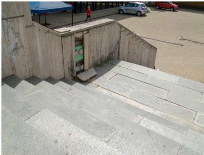
24. ábra: Leesett burkolat a pályaudvari lépcsőn Forrás: koroshircentrum.hu
