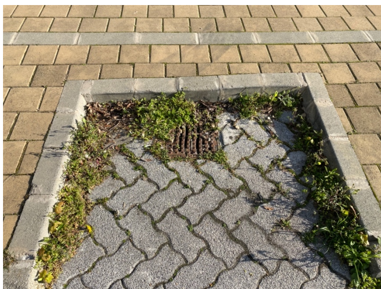
31. kép - Elhanyagolt állapotú csapadékvízvezető
