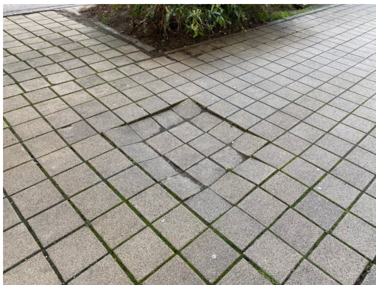
27. kép - Megsüllyedt járdafelület
