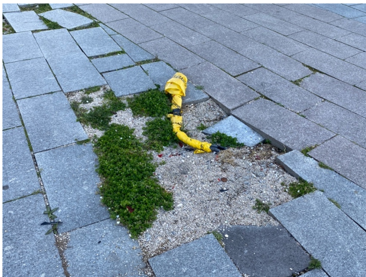
26. kép - Hiányzó térköburkolat, kiálló elektromos kábelek
