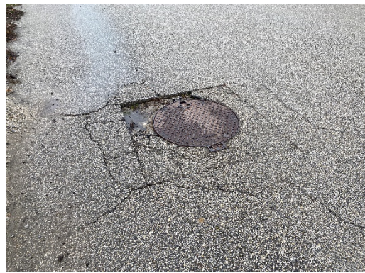
15. kép Panoráma utca, közműszerelvény csatlakozásából adódó
