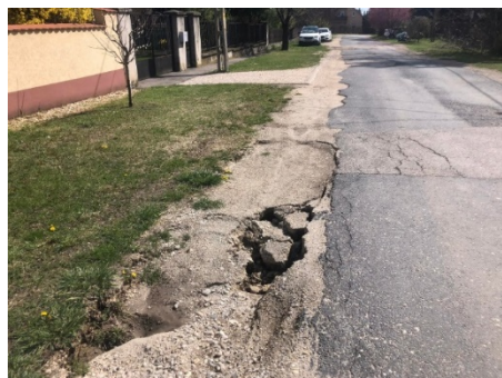
9. kép Beszakadt útpadka
