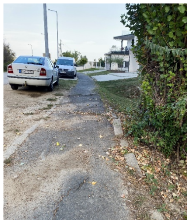
24. kép Panoráma utcában rossz állapotban lévő járda
