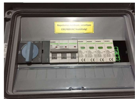
3. Kép AC leválasztó túárláram túlfesz- védő
