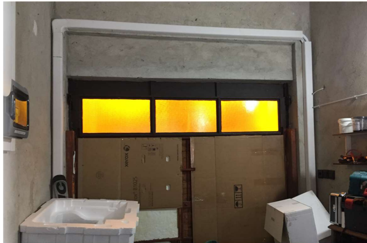
4. Kép A DC kábelozás és a klímavezeték kábelcsatornában
