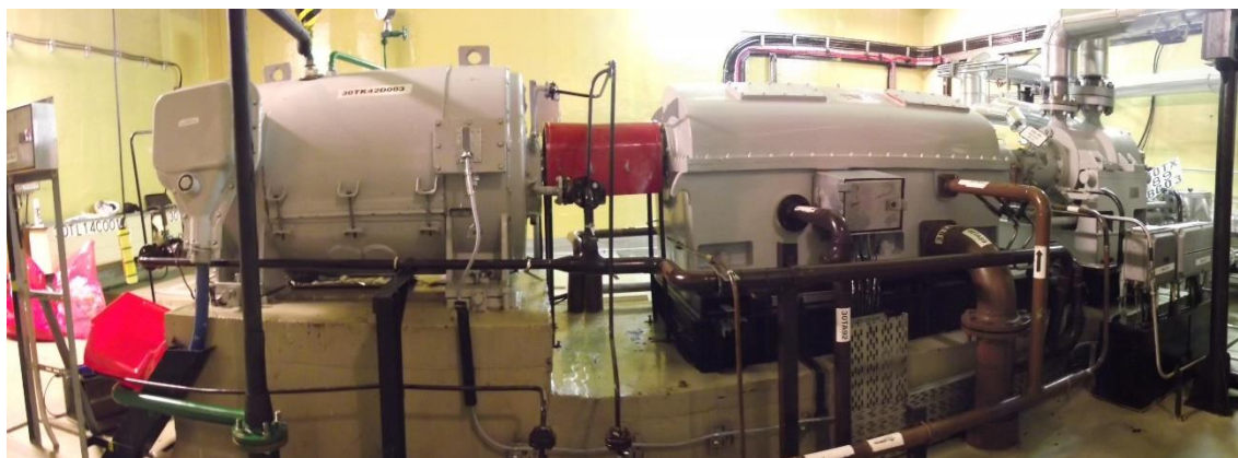
8. ábra Pótvízszivattyú egység hűtővíz és kenőolaj csővezetékekkel 18
