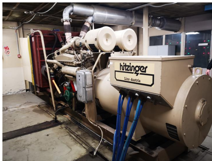
10. ábra Telepített diesel áramfejlesztő (3)
