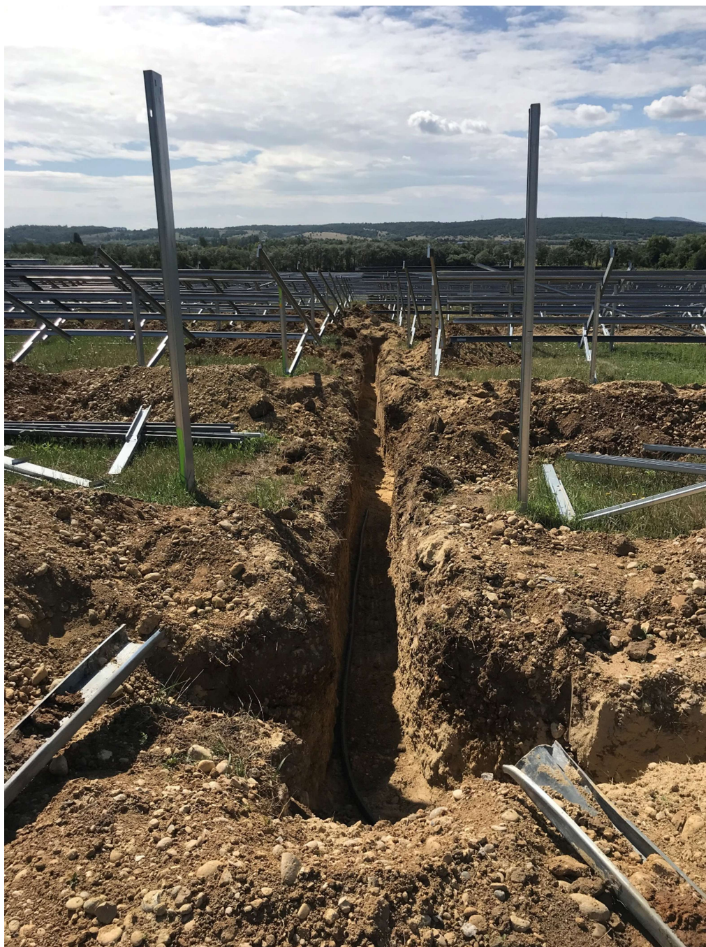
10. ára KIF kábelárok az asztalok között
