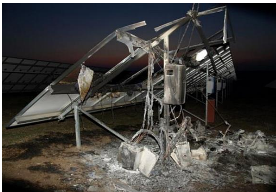
1. ábra villámcsapás egy földre telepített napelemes rendszerénél [4]
