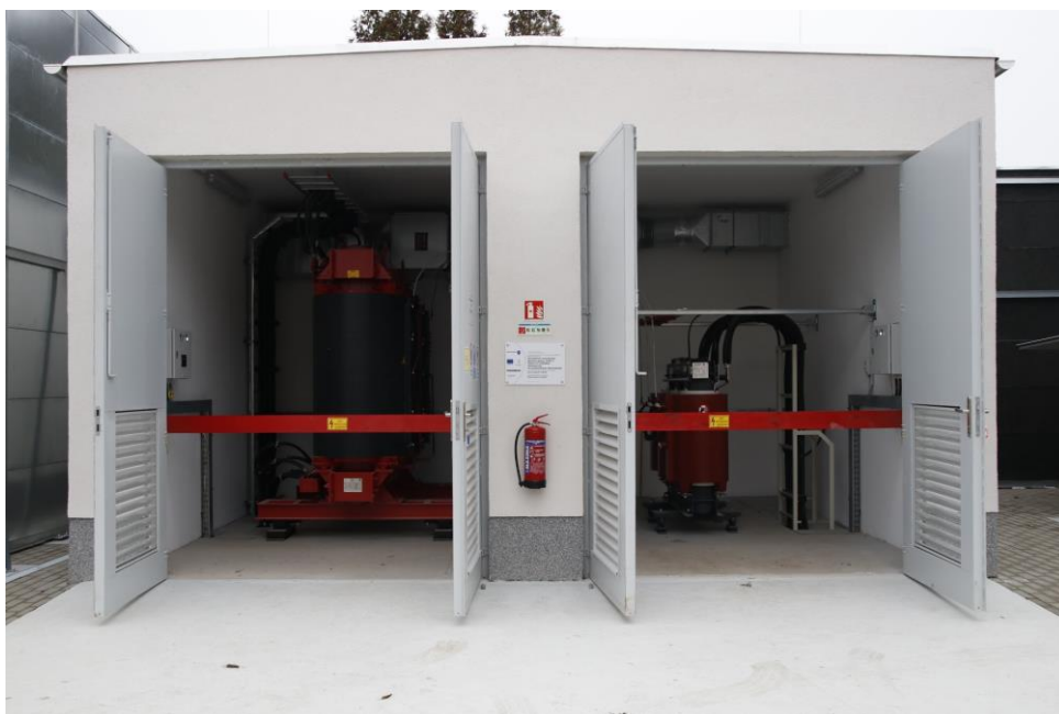
Ábra 9.5: BESS1 (jobbra) és BESS2 (balra) transzformátorai [36]
