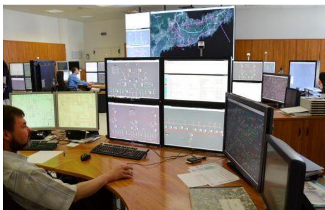
25. ábra 120 kV-os átviteli és elosztóhálózati üzemirányító központ - ÉMÁSZ Hálózati Kft, Miskolci Üzemirányító központ [25]
