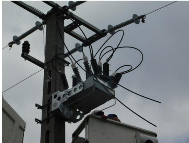
14. ábra Recloser telepítése NKM keretében [11]
