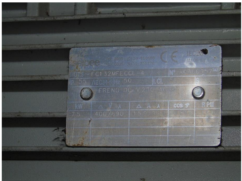
3. ábra Zsilipemelő motor
