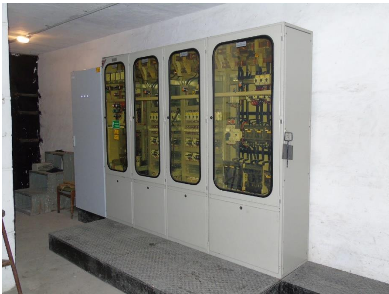
17. ábra 0,4 kV-os kapcsolótér
