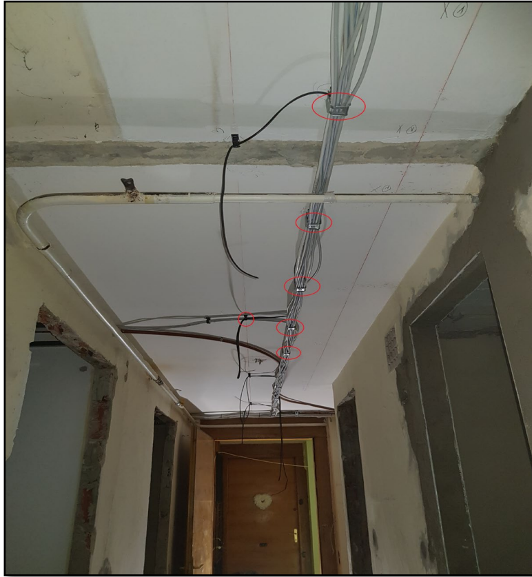
25. ábra Kábelsávrögzítő a mennyezeten
