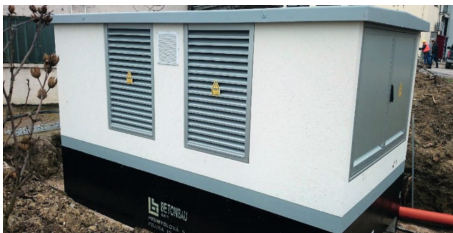
15. ábra: Betonházas transzformátor állomás
