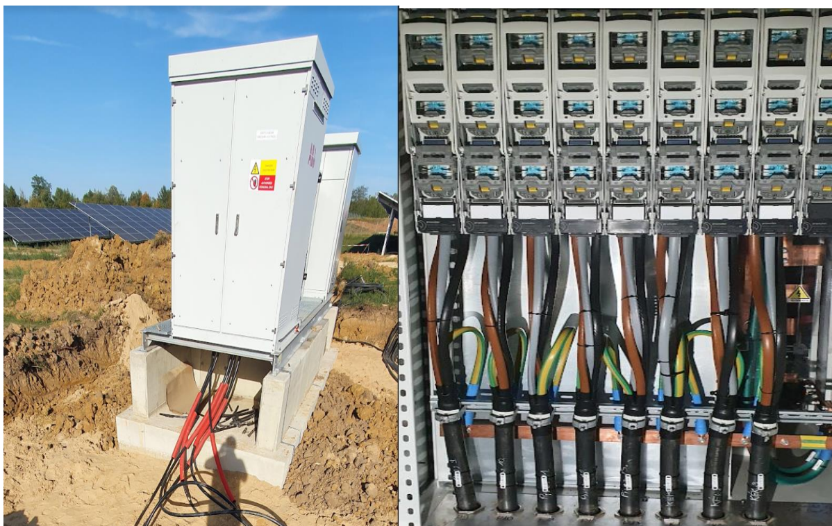
3.1.2. kép: AC oldali 0,4 kV-os fogadó
