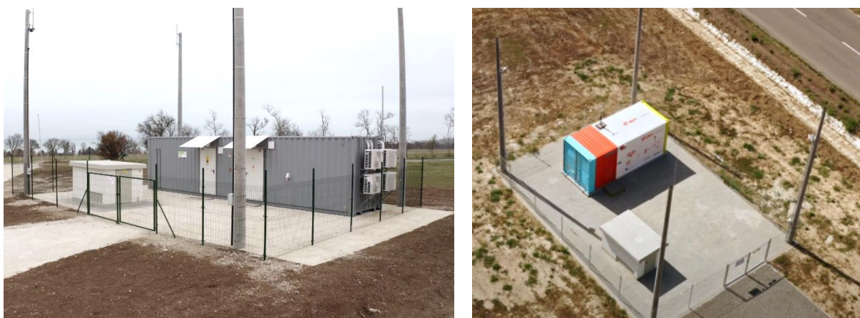
4. kép az E.ON akkumulátoros energiatárolói Zánkán (bal) és Dúzson (jobb) [27]
