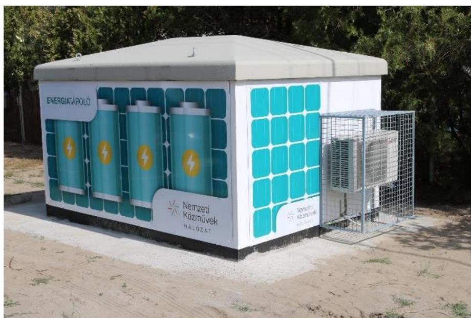
3. kép KIF-re csatlakozó akkumulátoros energiatároló Zsombón [29]
