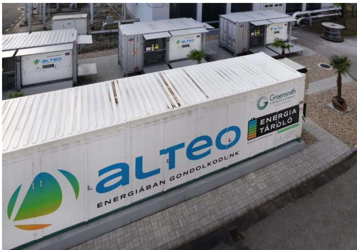
1. kép a zuglói energiatároló egységei: akkumulátor konténer (alul) és 3 db inverter-transzformátor modul (felül) [20]
