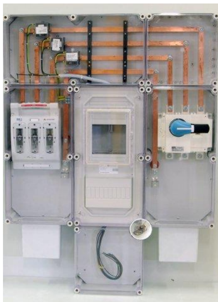
1. ábra Csatári Plast PVT EON 9090 N3x400A áramváltós mérőhely
