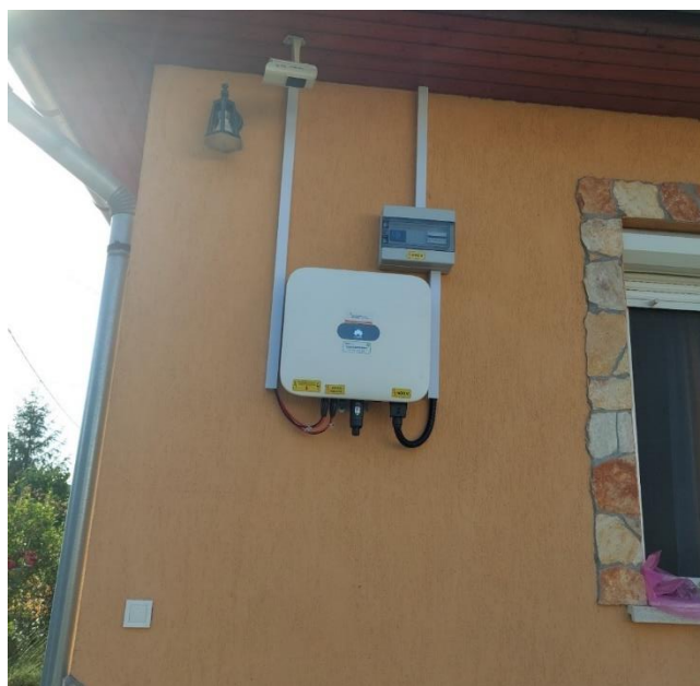
20. ábra - A telepített inverter kiviteli képe
